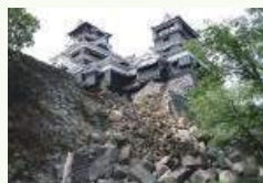
地震により損害を受けた熊本城
